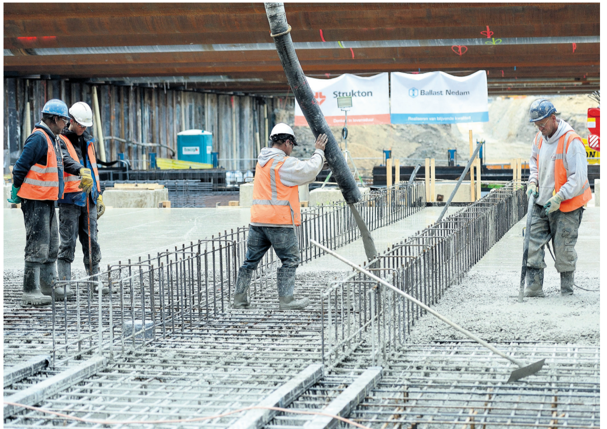
Bouwwerkers storten beton bij de aanleg van een tunnel. Tussen de betonproductie en de sloop van gebouwen zit vijftig jaar, door het ketenoverleg komen betonfabriek en recyclebedrijf veel dichterbij elkaar.
